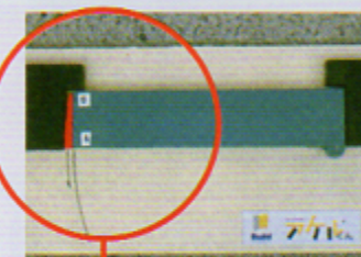
戸先側ドア枠が歪んだ状態。
